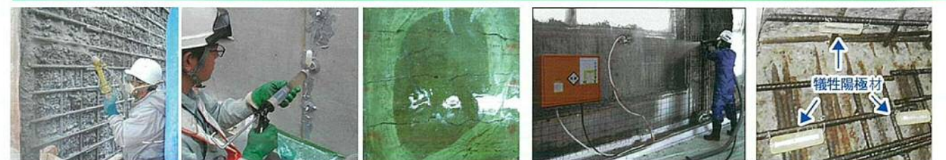
吹付工法施工状況 (左) ひび割れ注入工施工状況 (中) 剥落対策工施工状況 (右)
